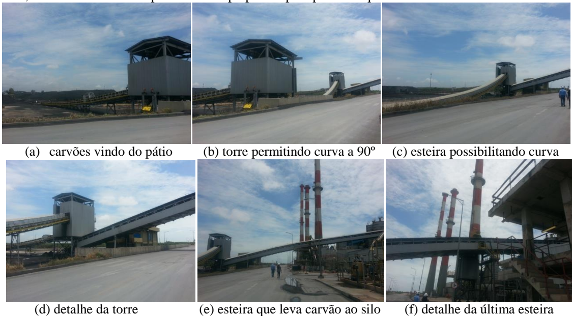
Figura 6 - Esteiras transportadoras de carvão instaladas dentro da termelétrica para levar os carvões aos silos, onde o combustível é pulverizado e preparado para posterior queima.
