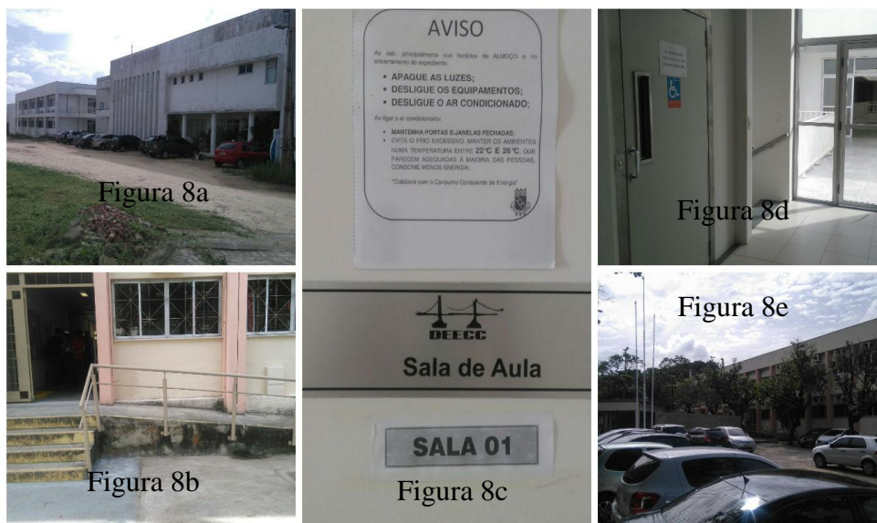
Figura 8 – Inconformidades encontradas no Centro de Tecnologia da UFC quanto aos equipamentos de acessibilidade arquitetônica.
