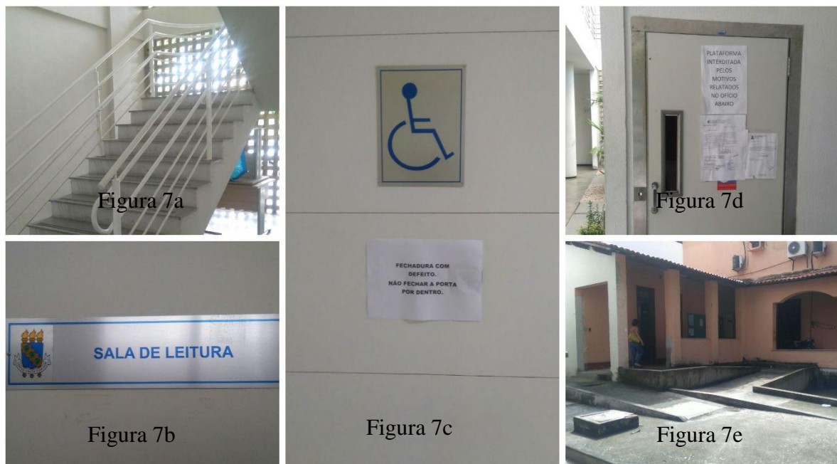
Figura 7 – Não conformidades encontradas no Centro de Humanidades da UFC quanto aos equipamentos de acessibilidade arquitetônica.
