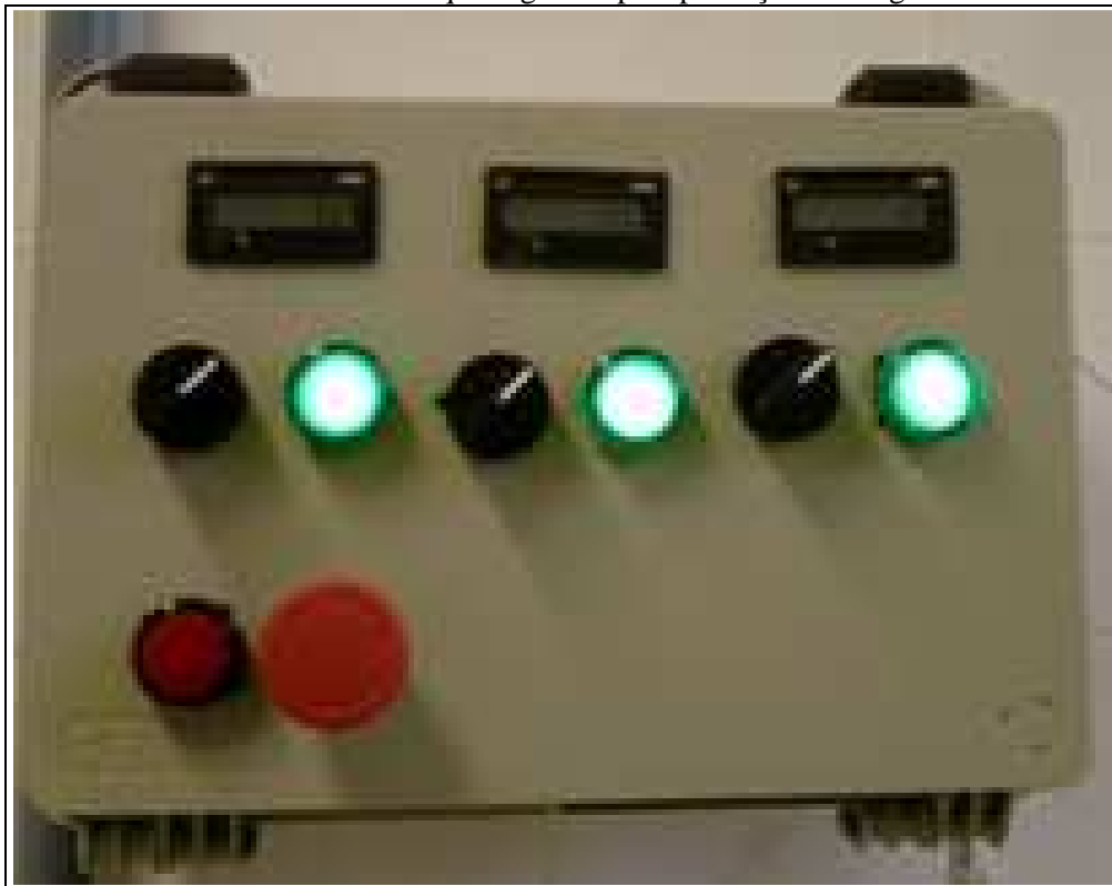
Figura 10 – Quadro elétrico onde eram mensurados os pulsos gerados pelo deslocamento do líquido gerado pela produção de biogás
