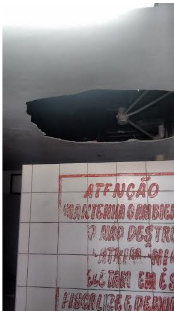
Principal reclamação da diretora, banheiro está com buracos no teto e outros problemas (FOTO: HayanneNarlla/ Tribuna do Ceará)
