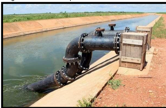
Fotografia 14 – Adutora que abastece a Fazenda Melancias
