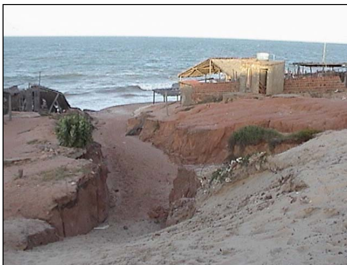
Figura 19 – Voçorocas causadas pela ação das águas pluviais (Foto: Projeto Canoa, 2002)
