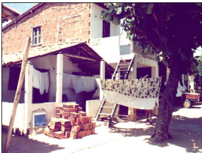
Figura 30 – Acesso improvisado ao pavimento superior de uma residência voltado para a propriedade vizinha. (Foto da autora, agosto de 2002)
