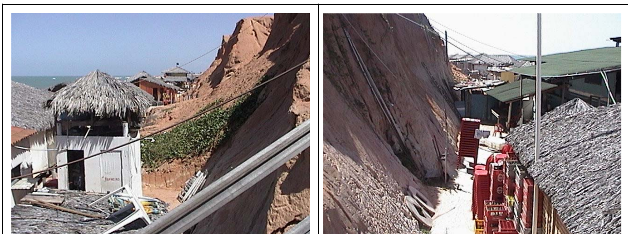
Figura 23 – Sopés das falésias nos fundos das barracas utilizados para armazenamento de entulho ou instalação de tanques de esgoto. (Fotos: Projeto Canoa, 2002).
