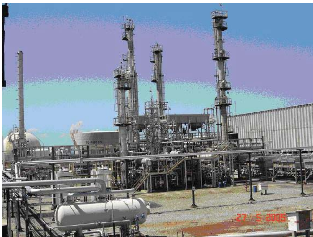
Figura 30 - Visão geral da UPGN. Fonte: Petrobras, 2008.
