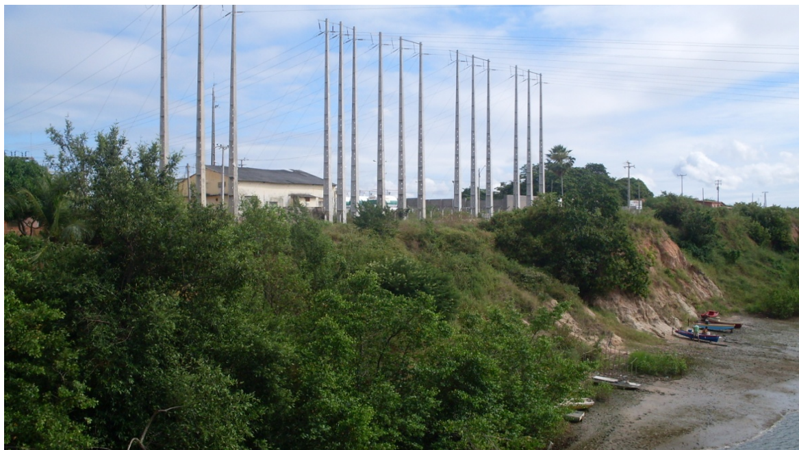
Figura 31 - Subestação da Coelce em Aracati, inserida numa APP.
