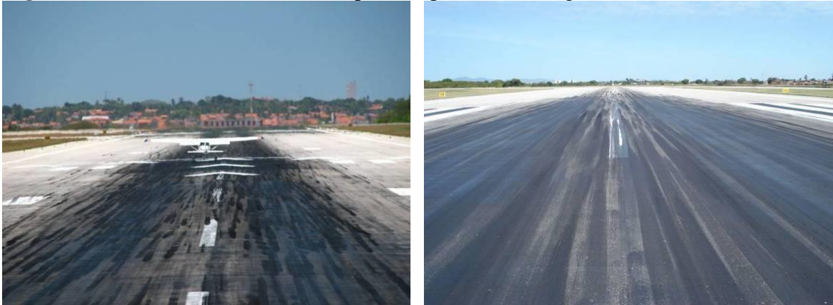
Figura 16 – Acúmulo de borracha em pista de pouso e decolagem.
