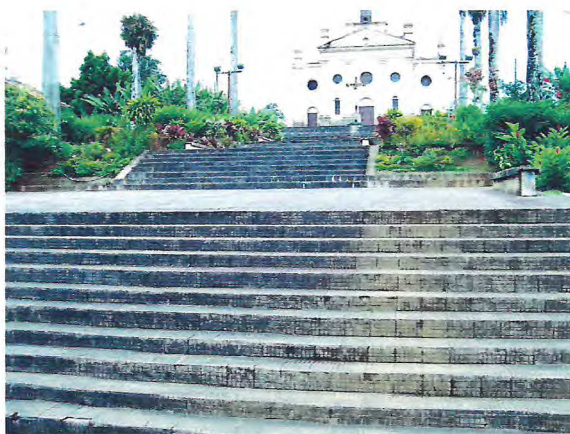
Figura 11 - Igreja Nossa Senhora da Conceição. A dificuldade de acesso para idosos e deficientes em escadaria desprovida de rampa e corrimão. Fonte: Autor (2008)
