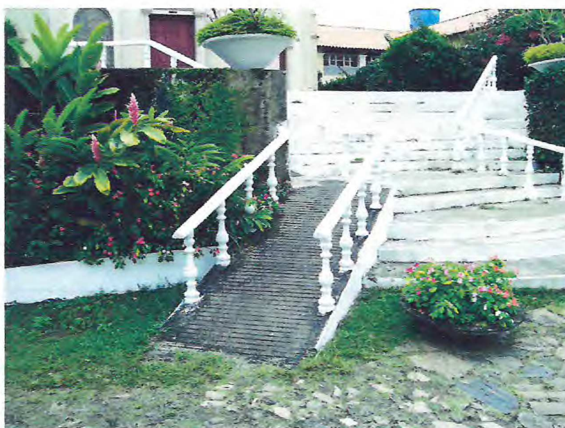
Figura 10 - Igreja Nossa Senhora de Lourdes. Rampa com dimensões impróprias ao uso por cadeirantes. Fonte: Autor (2008)
