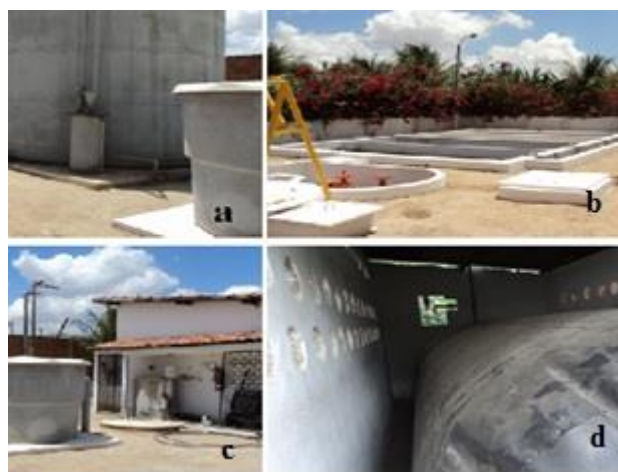
Figura 9 - ETE Aracapé III – a) reatores anaeróbios, b) leitos de secagem, c) unidades de desinfecção, d) gasômetro.
