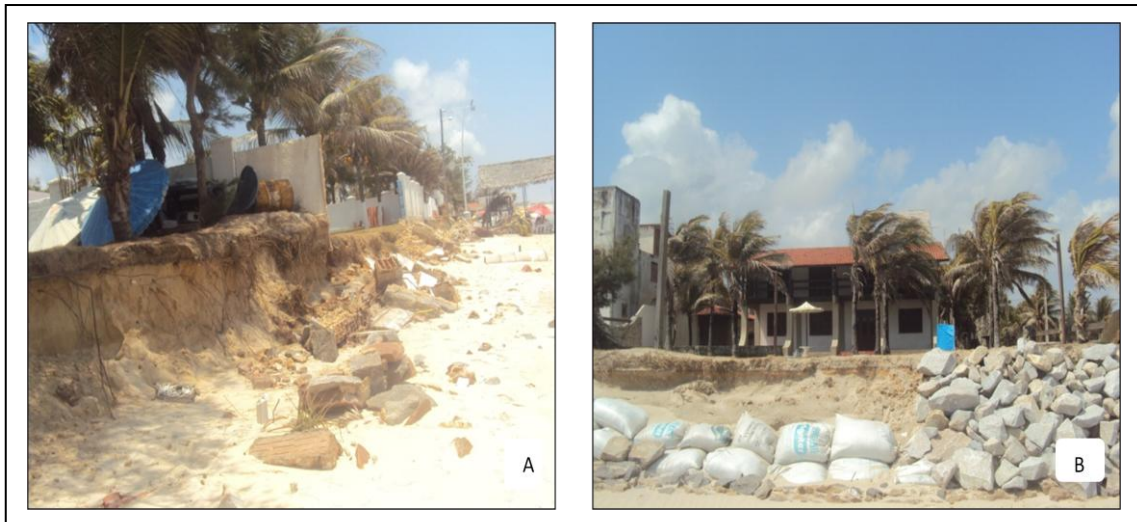
Figura 15 - Evidencias de processos erosivos na faixa de praia do Iguape.
