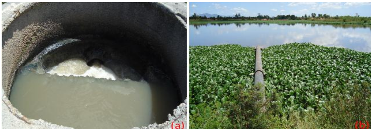
Figura 17 – (a) Entrada da estação (b) Lagoa Facultativa da ETE Conj. Esperança, Fortaleza/Ce.
