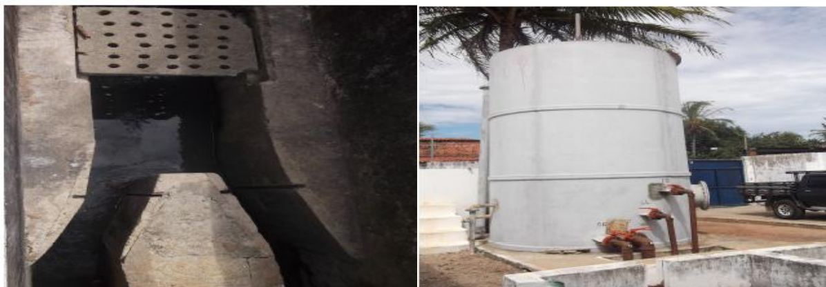
Figura 5 - (a) Calha Parshall (b) Reator tipo UASB da ETE Itaperi I, Fortaleza/Ce.
