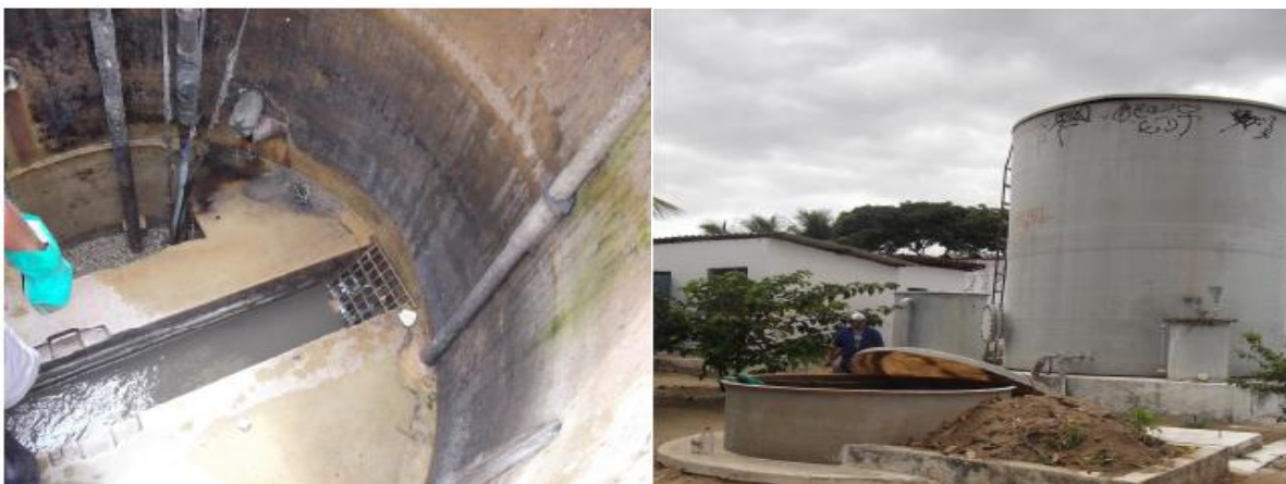
Figura 6 – (a) Ponto coleta na entrada da ETE e (b) Reator UASB da ETE Dias Macedo Fortaleza/Ce.
