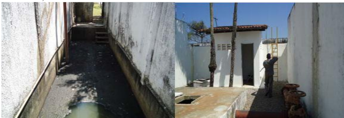
Figura 37 – (a) calha parshall coberta por afluente e (b) módulos da estação da ETE Almirante Tamandaré, Fortaleza/Ce.
