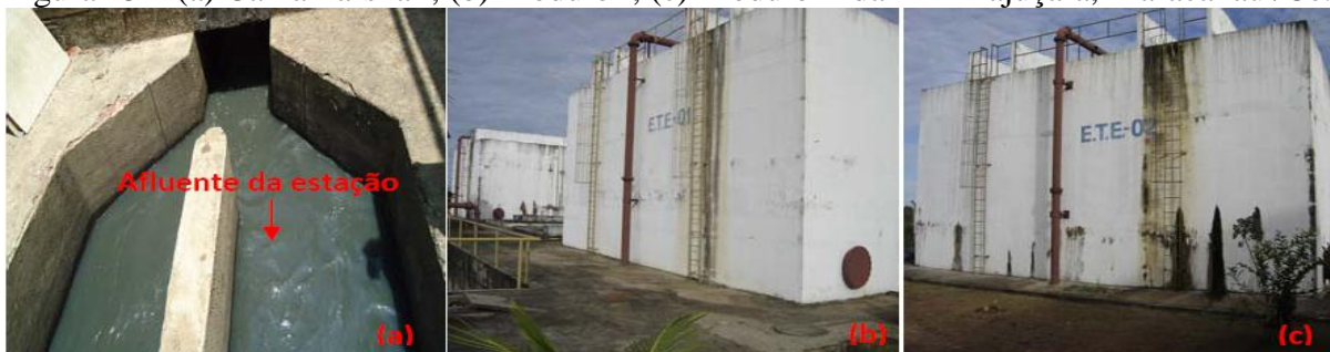
Figura 25 – (a) Calha Parshall, (b) Módulo I, (c) Módulo II da ETE Pajuçara, Maracanaú /Ce.
