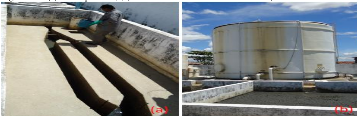
Figura 22 – (a) Calha parshall, (b) Reator UASB da ETE Sítio Santana, Fortaleza/Ce.
