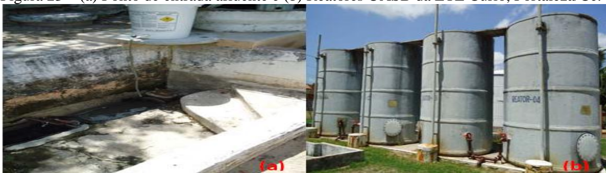
Figura 23 – (a) Ponto de entrada afluyente e (b) Reatores UASB da ETE Curió, Fortaleza/Ce.
