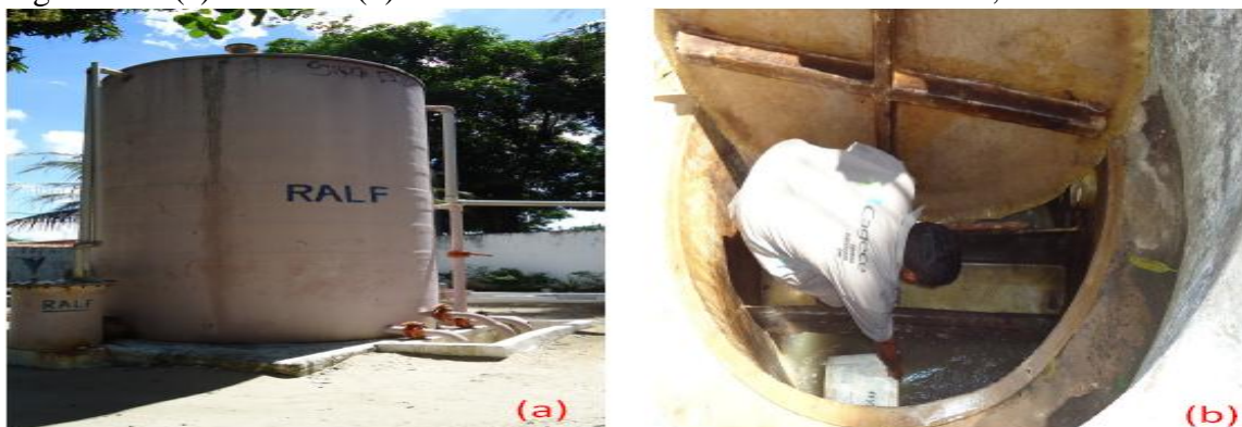
Figura 11 – (a) Reator e (b) Ponto de Coleta da ETE Novo Mondubim, Fortaleza/Ce.
