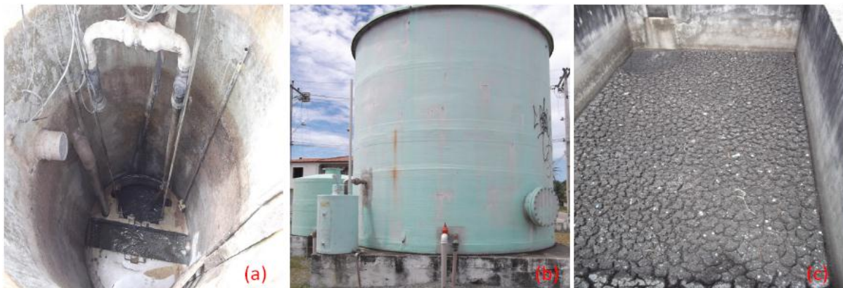
Figura 13 – (a) Entrada da ETE, (b) Reator UASB, (c) Leito de secagem da ETE Pindorama, Fortaleza/Ce.
