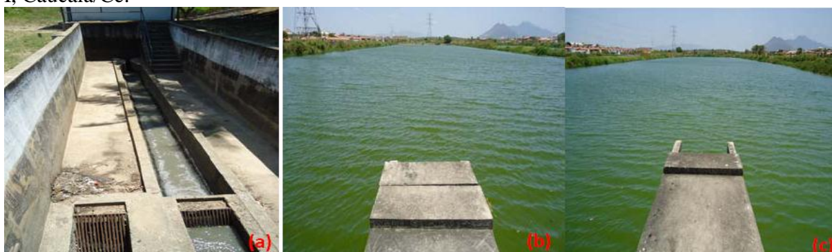
Figura 35 – (a) Calha parshall, (b) Lagoa facultativa I, (c) Lagoa facultativa II da ETE Araturi I, Caucaia/Ce.
