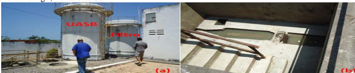
Figura 26 – (a) Reator UASB e (a) Filtro Anaeróbico (b) Calha Parshall da ETE Rosa de Luxemburgo, Fortaleza/Ce.
