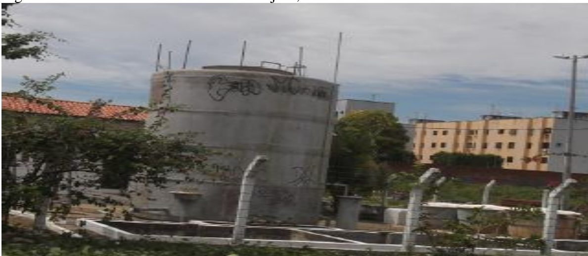
Figura 10 – Reator UASB da ETE Zeza Tijolo, Fortaleza/Ce.
