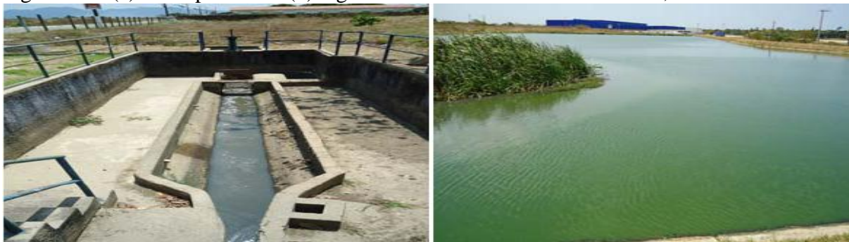
Figura 33 – (a) calha parshall e (b) lagoa facultativa da ETE Jereissate III, Pacatuba/Ce.
