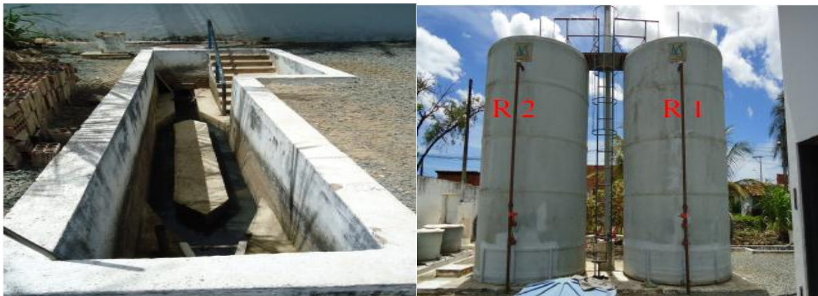
Figura 9 – (a) Calha parshall (esquerda) e (b) Reatores (direita) da ETE Lago Azul, Fortaleza/Ce.
