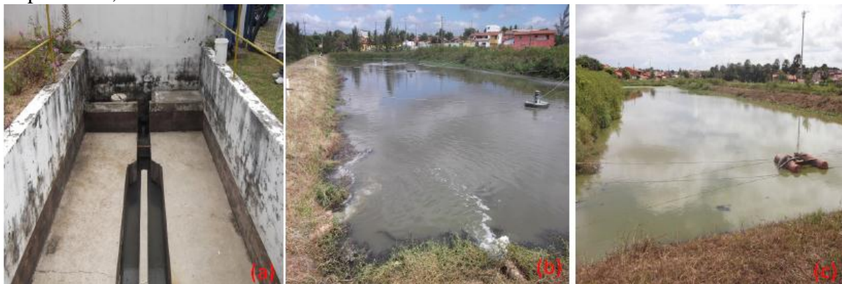
Figura 20 – (a) Calha parshall, (b) Lagoa Facultativa Aerada, (c) Lagoa de Maturação da ETE Tupã Mirim, Fortaleza/Ce.
