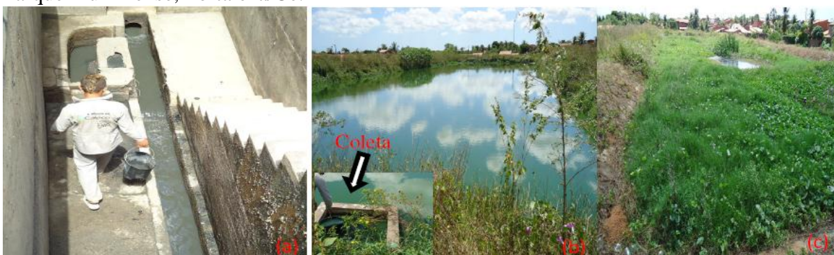
Figura 18 – (a) Entrada da ETE, (b) Lagoa de Estabilização, (c) Lagoa Anaeróbia da ETE Parque Fluminense, Fortaleza/Ce.
