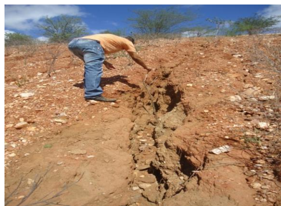
FIGURA 6 - Erosão generalizada no talude de jusante.
