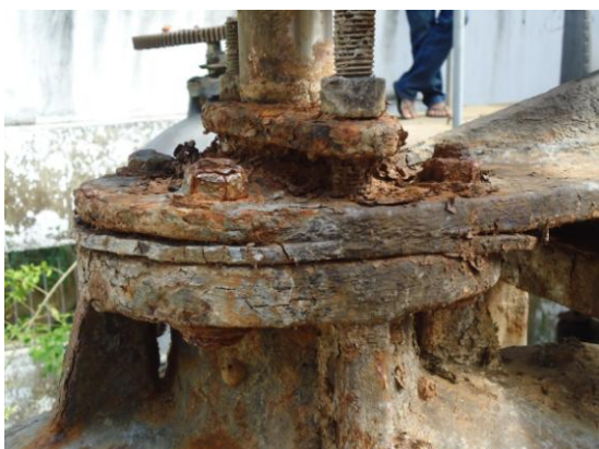
FIGURA 5 - Registro de controle de vazão da estrutura de saída apresentado alto grau de corrosão.
