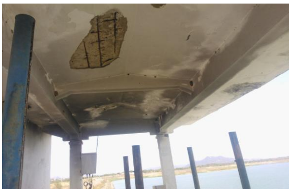
FIGURA 29 - Ferragem exposta no teto da torre da tomada d'água da Barragem Itans – RN.
