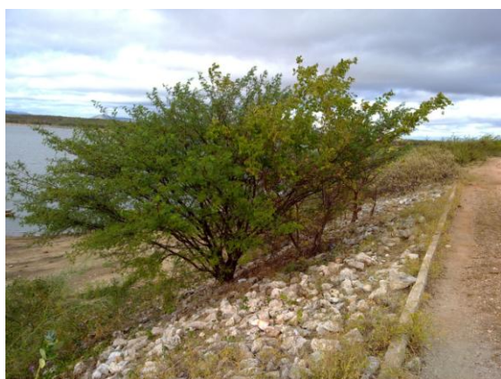
FIGURA 25 - Árvores no talude de montante da Barragem Caldeirão de Parelhas- RN.
