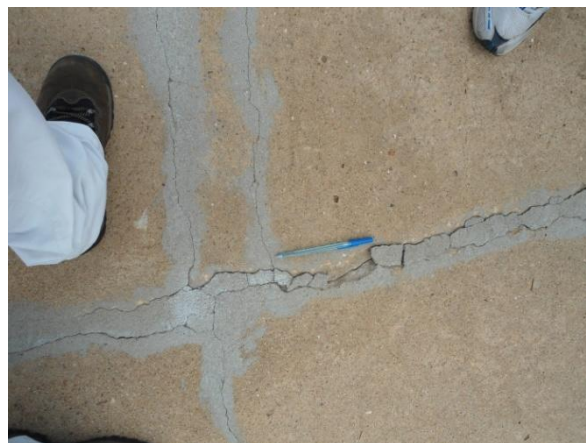
FIGURA 24 - Tratamento sem resultado das trincas na soleira do vertedouro da Barragem Cocorobó-BA.
