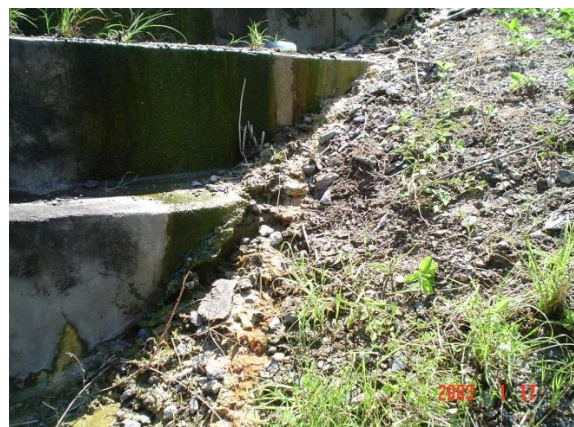
FIGURA 34 - Detalhe da percolação no paramento de jusante junto à ombreira esquerda com material esbranquiçado, Barragem Jucazinho – PE..
