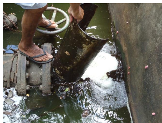
FIGURA 32 - Caixa de jusante com registros e tubulação danificada, Barragem Amanari- CE.
