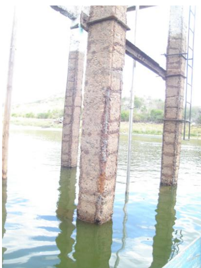
FIGURA 31 - Ferragem exposta dos pilares de sustentação da torre da tomada d'água da Barragem Sabugi – RN.
