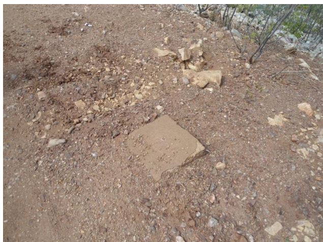
FIGURA 38 - Marco para medição de recalque inutilizado, Barragem Cocorobó – BA, 2013.
