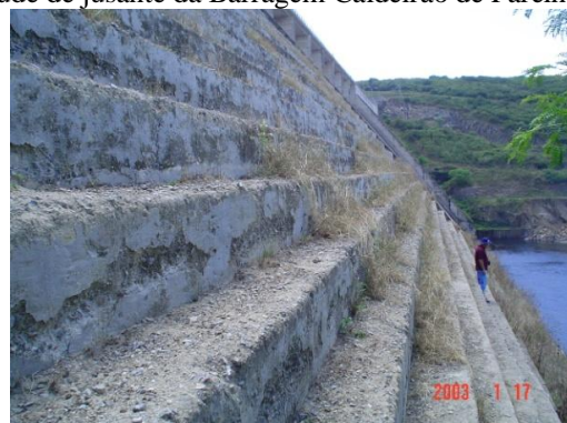
FIGURA 28 - Degradação do concreto no paramento de jusante da Barragem Jucazinho -PE.
