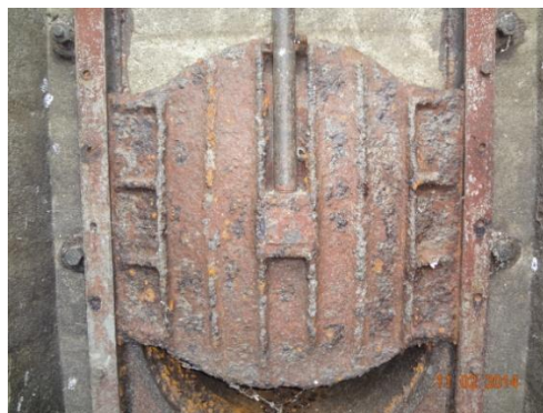
FIGURA 30 - Comporta da tomada d'água apresentando corrosão, Barragem Choró –CE.
