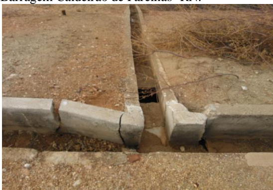
FIGURA 27 - Canaleta quebrada, Barragem Caldeirão de Parelhas- RN.
