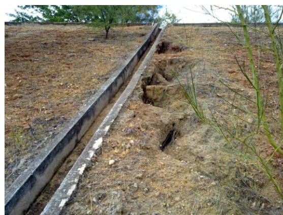
FIGURA 26 - Árvores e sulcos profundo de erosão no talude de jusante da Barragem Caldeirão de Parelhas..
