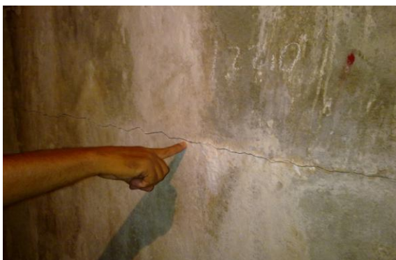
FIGURA 35 - Trincas no concreto da galeria de inspeção da Barragem Gargalheiras – RN.
