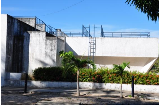
Figura 23 - ETE sem identificação. Campus do Pici, UFC. Fortaleza-CE
