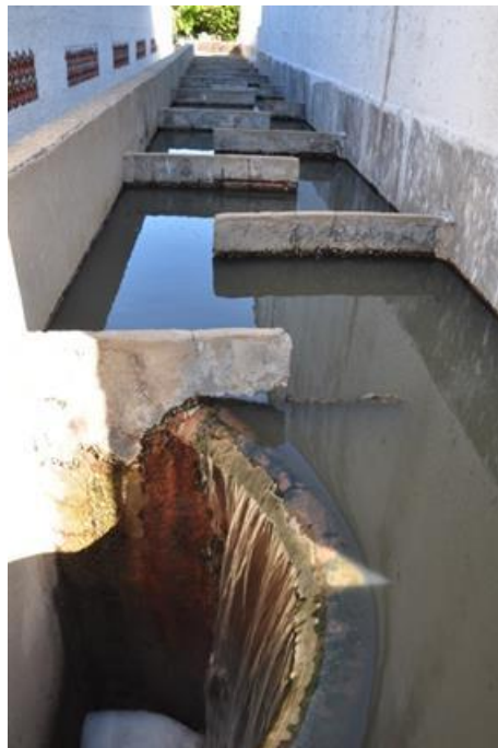
Figura 25 - Lançamento do Efluente da ETE do Campus do Pici, UFC. Fortaleza-CE
