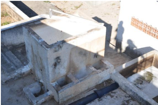
Figura 24 - Tanque de cloro, ETE do Campus do Pici, UFC. Fortaleza-CE
