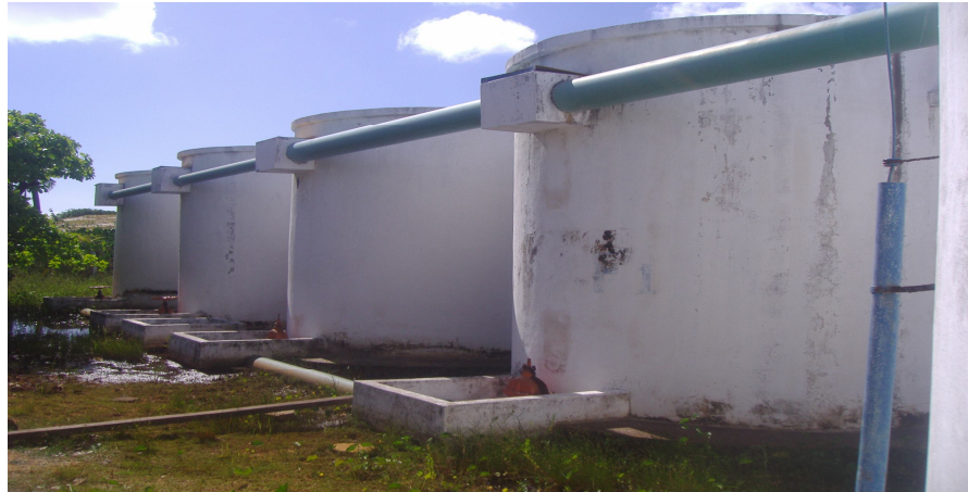
Figura 3.9: Estação de tratamento – CAGECE, Lagoa Grande. Paracuru – Ceará.
