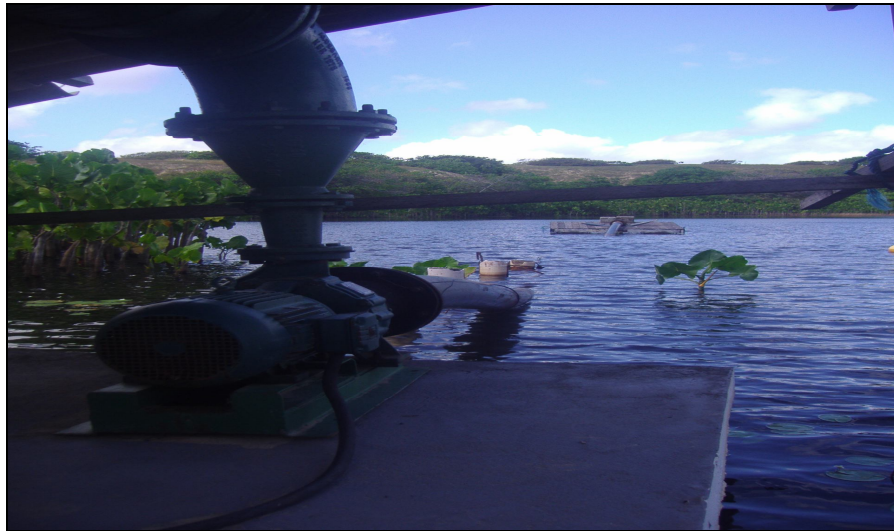
Figura 3.11: Parte do sistema captação de água da CAGECE. Fonte: Nascimento, A. P. 2009.
