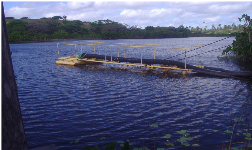
Figura 3.12: Sist de captação de água da Petrobrás em Paracuru-Ce. Fonte: Nascimento, A. P. 2009.
