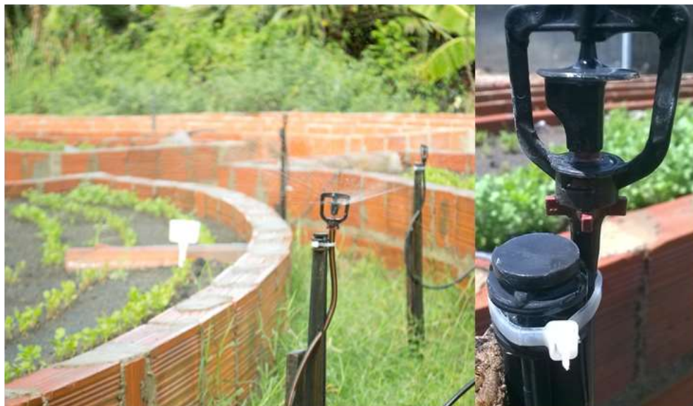
Figura 37: Microaspersores instalados em funcionamento
