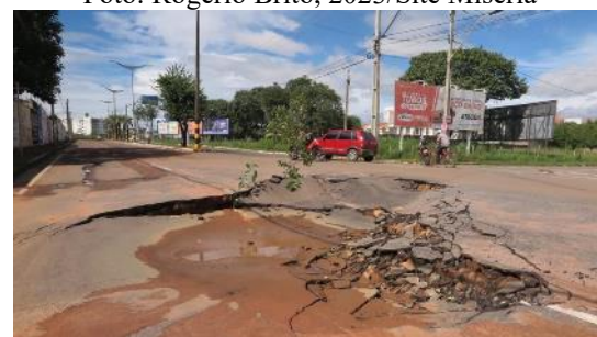
Figura 102: Asfalto cedido após chuvas intensas na av. Ailton Gomes
