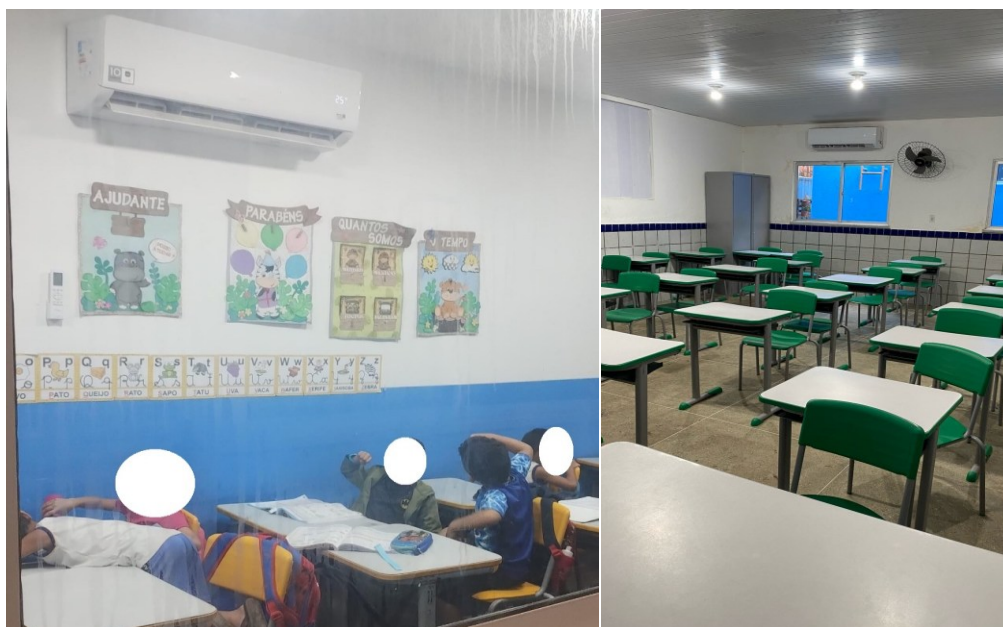
Fotografia 12 – Ares-condicionados instalados em sala de aula
