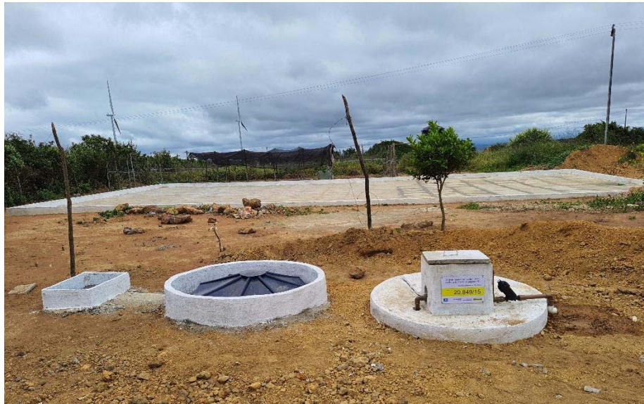
Figura 3 – Sistema RAC instalado.
