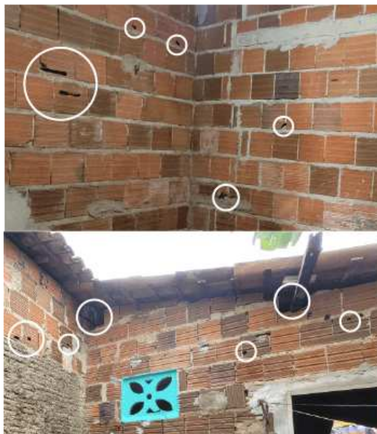
Figura 25 - Fissuras e Beiral das Casas 2 e 4
