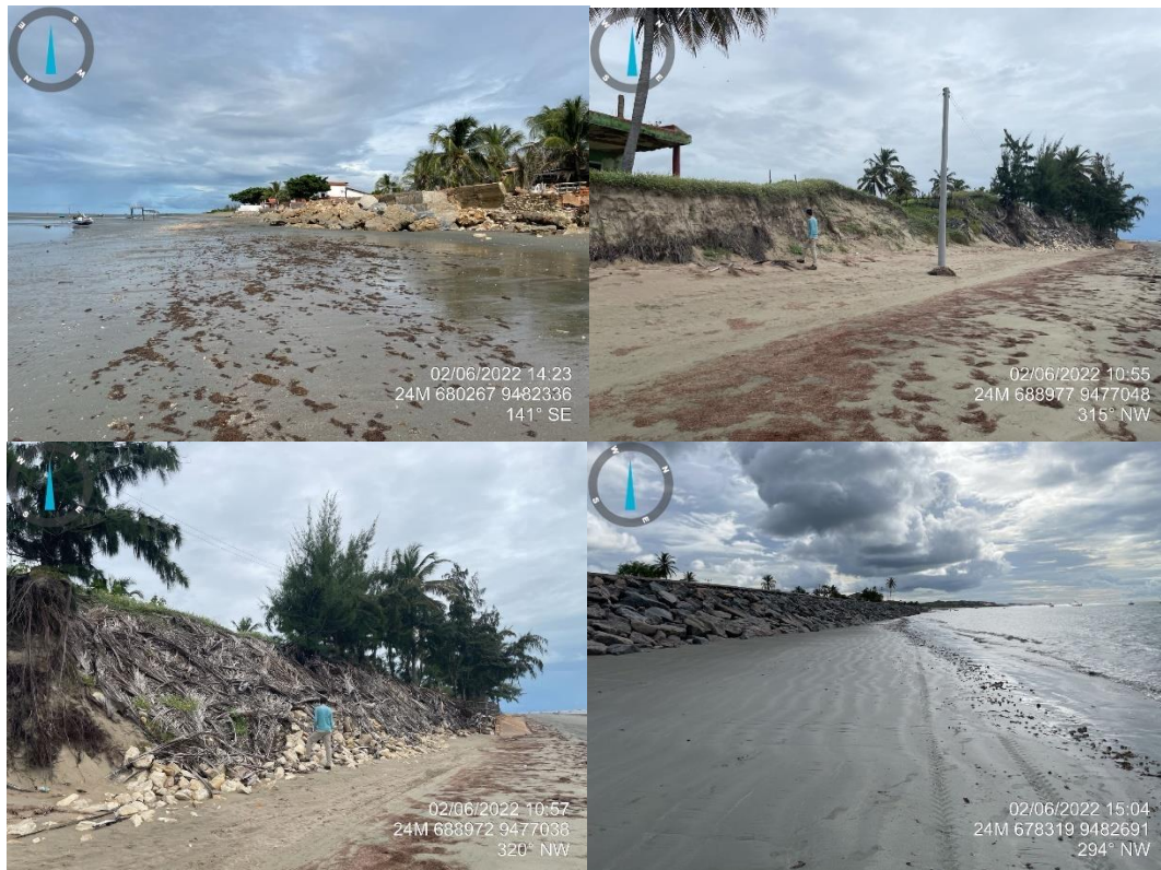
Figura 5 - Consequências dos processos erosivos na linha de costa defronte à planície de maré externa em seu lado NW (Praia de Requenguela).
