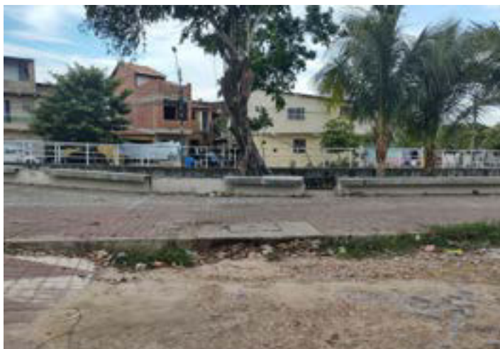
Figura 49 – Foto de bueiro após chuva, durante quadra chuvosa, com acúmulo de resíduos na Rua Gonçalves Lago, próximo ao Centro de Juventude.
