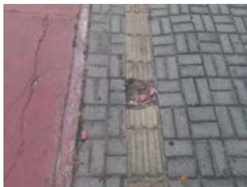
Figura 68 – Foto de piso tátil quebrado e implantado ao lado de blocos de concreto intertravado.
