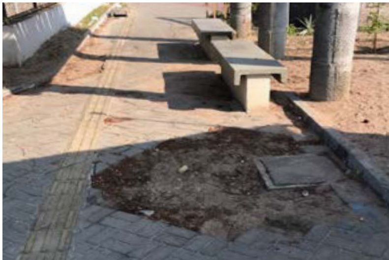
Figura 40 – Foto da pavimentação da calçada danificada próximo à caixa de inspeção.
