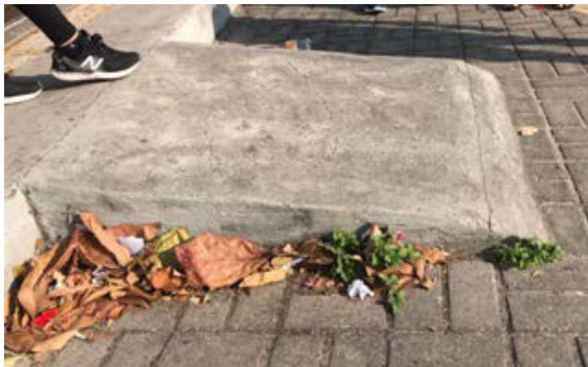
Figura 42 – Foto de rampa com duas inclinações diferentes, ambas superiores ao limite estabelecido pela NBR 9050.
