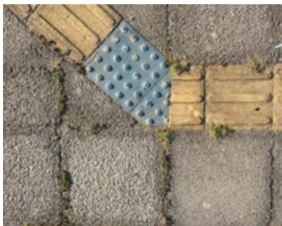
Figura 64 – Foto de piso direcional com inadequação na mudança de direção.
