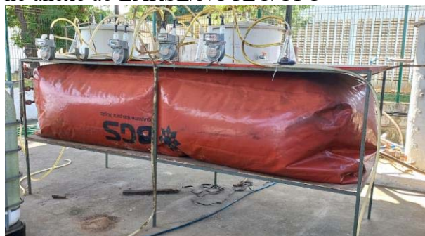
Figura 15 - Bag de recepção do biogás instalado no anexo ao LARSE/NUTEC/UFC
