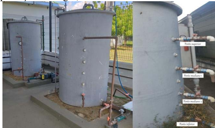
Figura 12 - Biodigestores utilizados no experimento (a esquerda) e pontos de coleta (a direita) – Área de produção de biogás, LARSE/NUTEC/UFC
