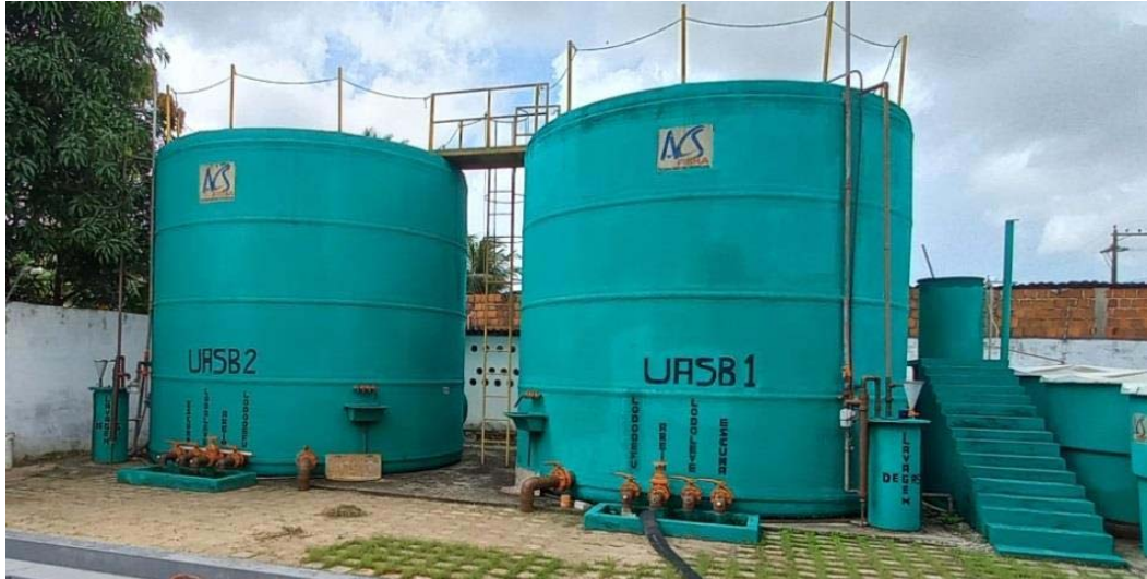
Figura 8 - Reator UASB da Estação de Tratamento de Esgoto Aracapé III - CAGECE
