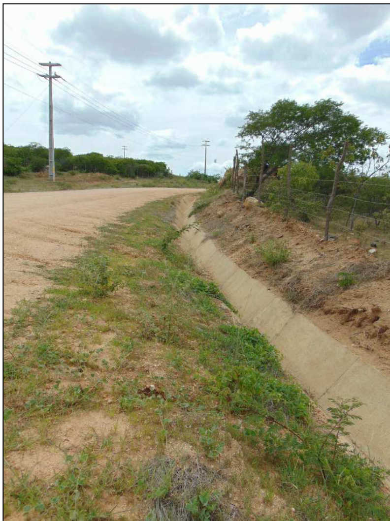
Figura 12 - Calhas de Escoamento de Águas Pluviais - 2023
