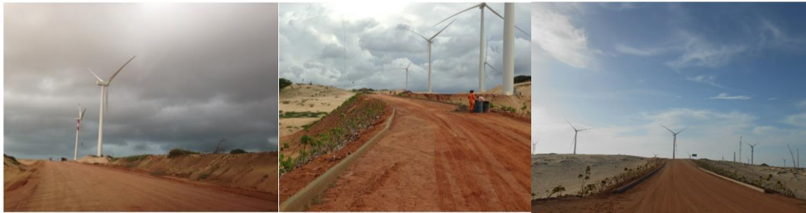
Figura 14 – Canteiro de Obras de um conjunto de parques eólicos em Trairi no ano de 2014
