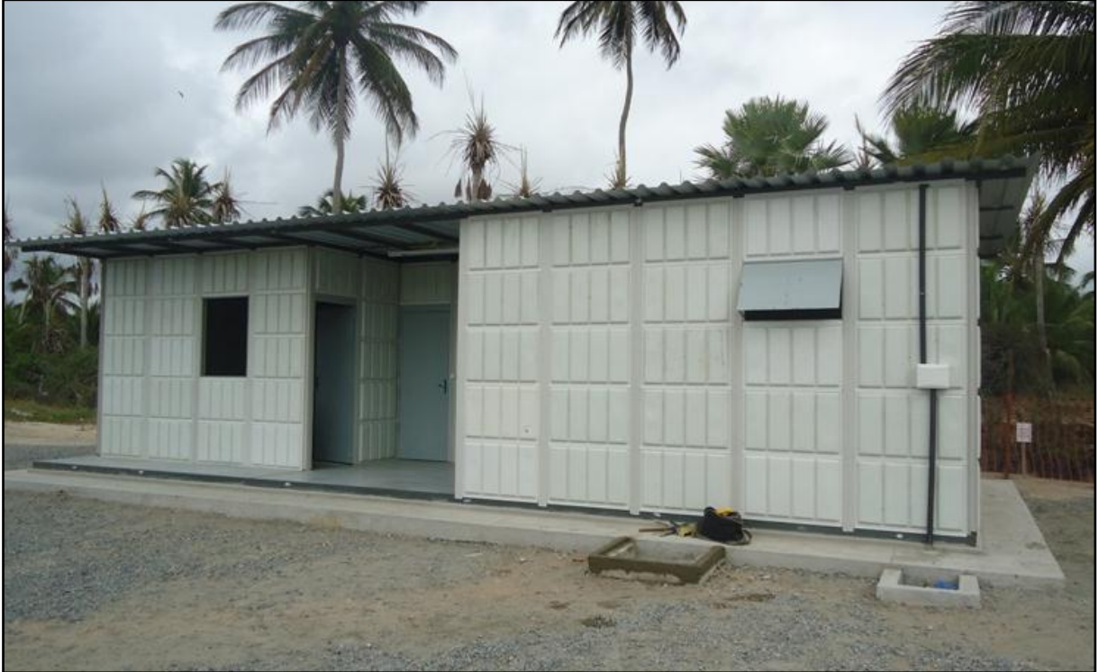
Figura 15 - Abrigo do canteiro sustentável
